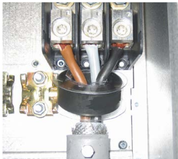
Obr. 55 Namontované feritové jádro na kabelu
